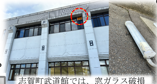
志賀町武道館では、窓ガラス破損
